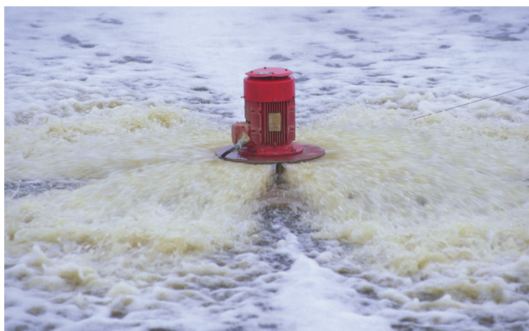
ÉPURATION DES LIXIVIATS DE CET - AÉRATEUR - ● SOURCE: JL CARPENTIER
