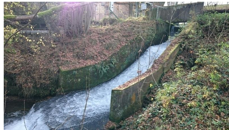
Obstacle infranchissable sur le Ton au moulin de la Paix à Saint-Léger.
