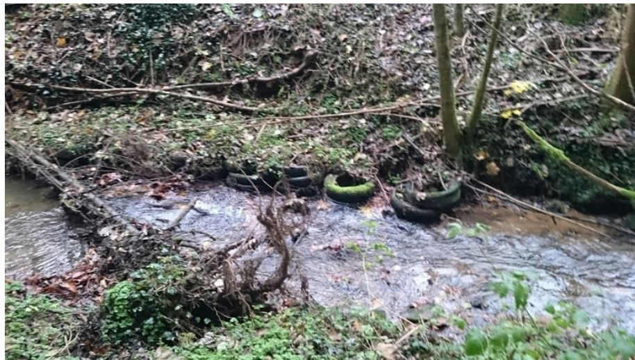
Protection de berge faite de pneus entassés les uns sur les autres sur le Ton à Saint-Léger.
