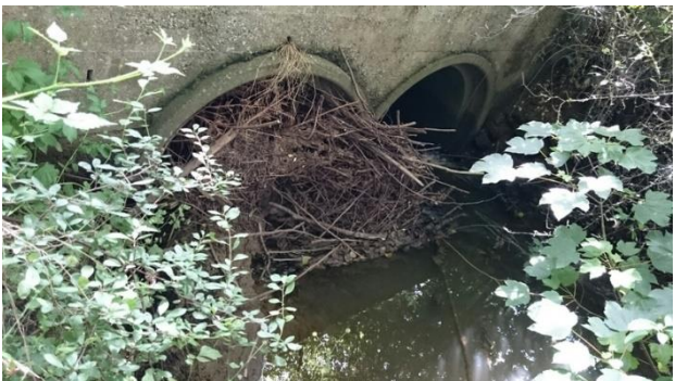
Pertuis bouché sur le Rau du Fond du Haza au niveau du passage sous la N88 à Musson (problème d'inondation).
