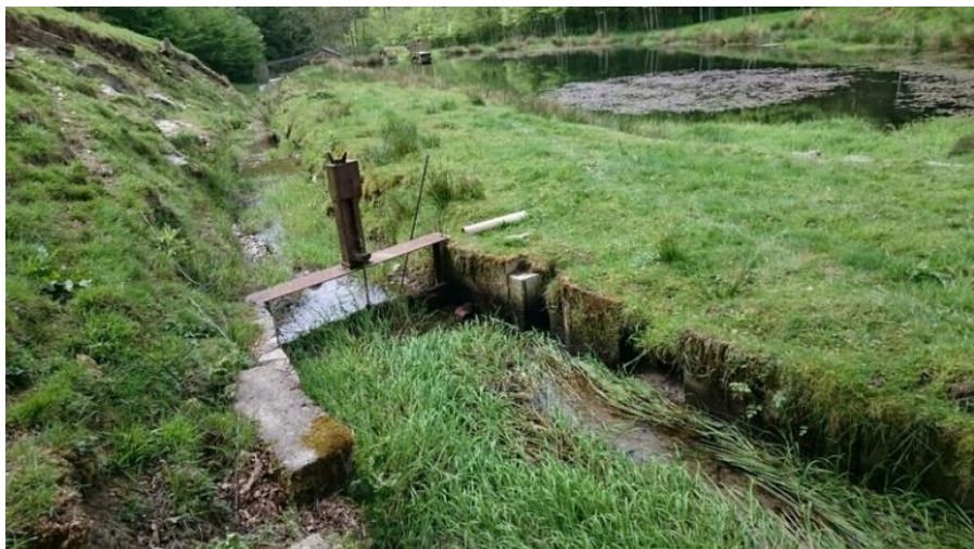
Gros captage pour des étangs sur le rau de Noirefontaine.
