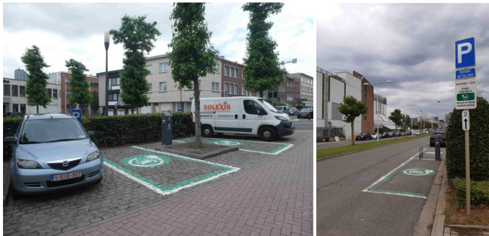
Exemples des récentes installations de recharge pour voitures électrique aménagées à Berchem (rue de Grand-Bigard, à gauche, avenue Marie de Hongrie, à droite).
