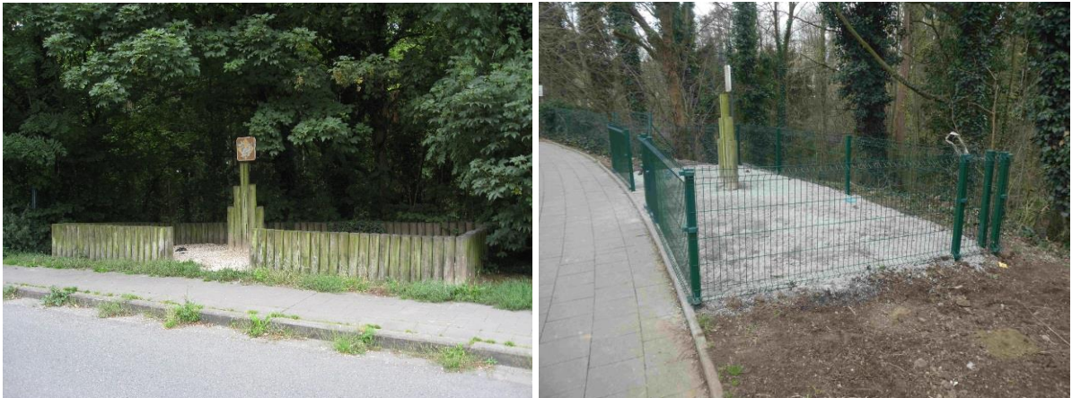
Les canisites d'antan (à gauche) cèdent la place à des installations rénovés allégées.
