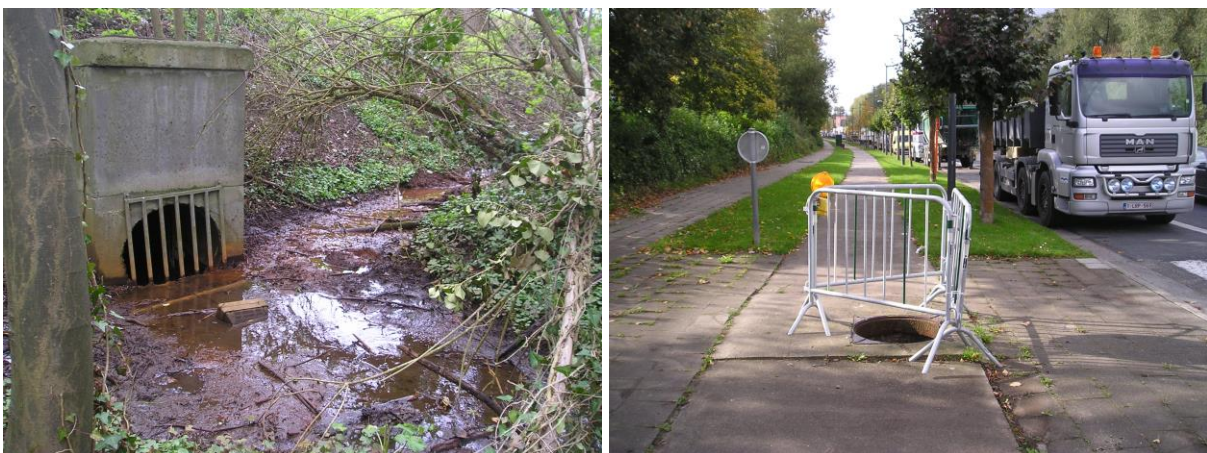
Bois inondable de la rue de l'Azur (à gauche), le ruisseau disparaît dans un collecteur dont on retrouve une chambre de visite avenue du Hunderenveld (à droite).
