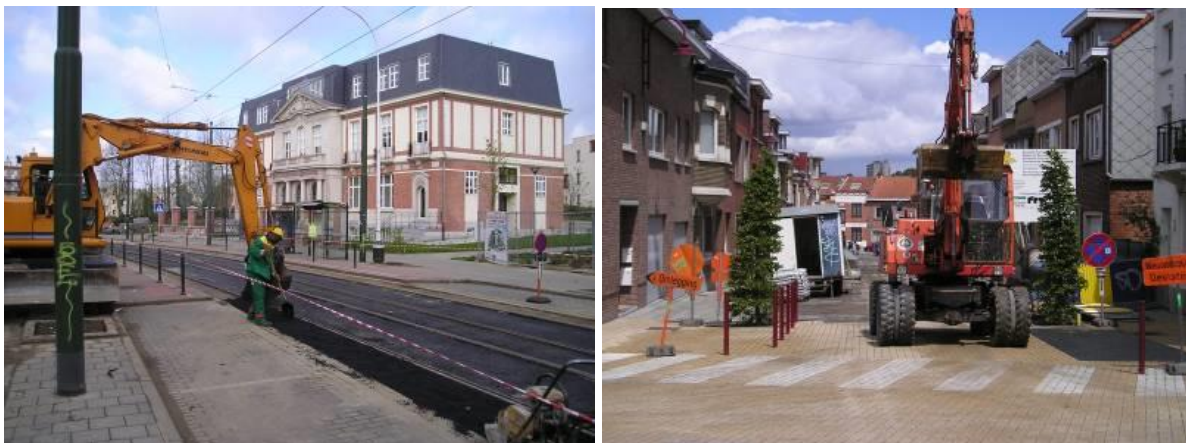
Avenue Goffin et rue Van Nieuwenborgh. Exemples d'interventions lourdes passées auxquelles on ne peut que recourir avec parcimonie.
