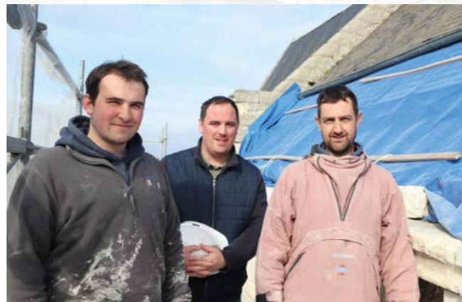
Romain Laumy, conducteur de travaux et appareilleur entouré des deux tailleurs poseurs de pierre, passionnés par leur métier, qui ont travaillé pendant près d'un mois et demi à Bourgueil : Jérémie Kern, 20 ans de métier et Loïc Beraudy, 3 ans d'expérience.
