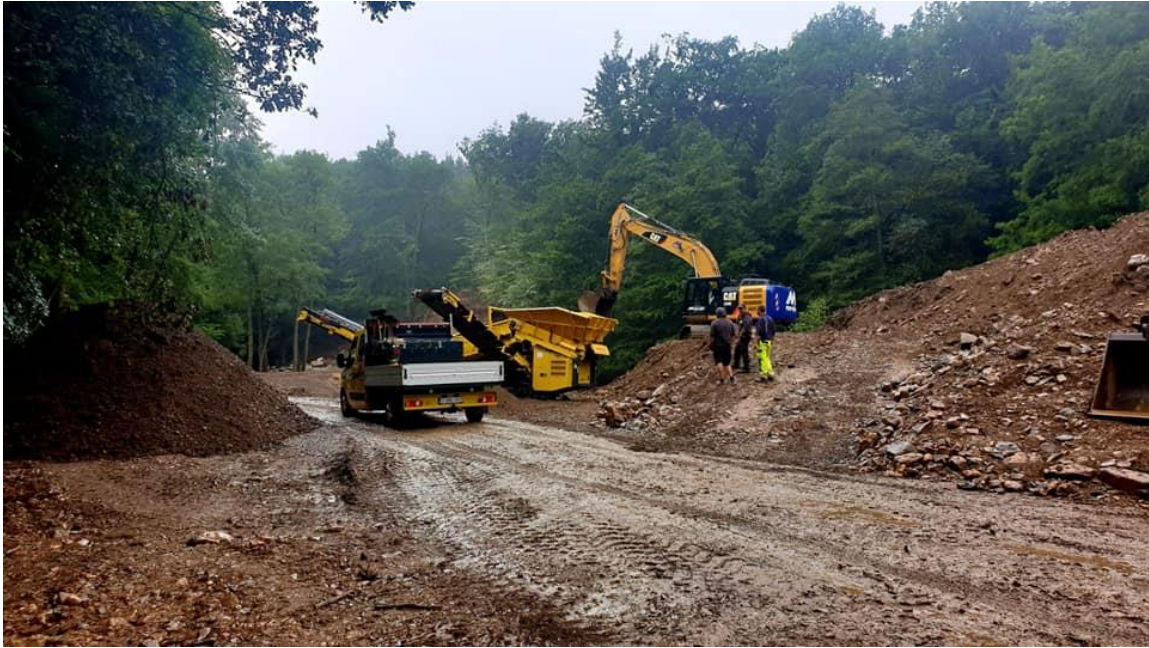
Effondrement d'environ 10 000m 3 de terres et de gravas d'une colline située en amont du restaurant de l'Atelier à Eupen (vue du dessous). Photo de Pierre Bleret.
