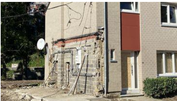
Aucune des maisons de ce quartier social n'a résisté au torrent © Laurent Henrard - RTBF
