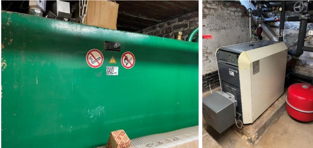
Figure 29 Chaudière de la chaufferie Est du château, et cuve à mazout dédiée (source : CSD, juill. 2023)
