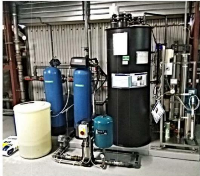
Figure 78 Centrale de production d'eau osmose dans le local technique C+5 (Source : CHU NDB, 2023)
