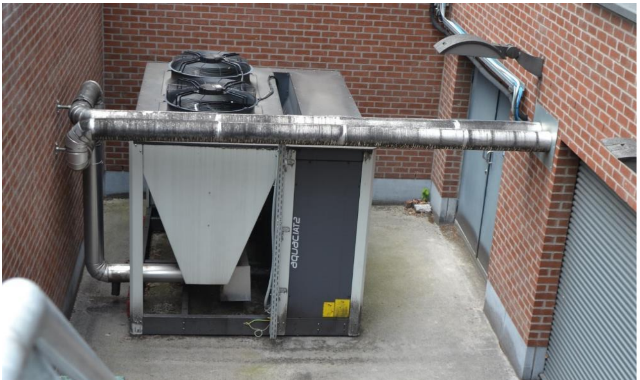
Figure 30 Machine froid, cour Niveau -2, aile E (source : CSD, juill. 2023)
