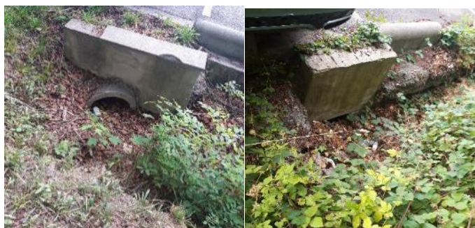
Figure 72 Réseau d'évacuation du parking P1 en partie bouché (source : CSD, Juil 2023)
