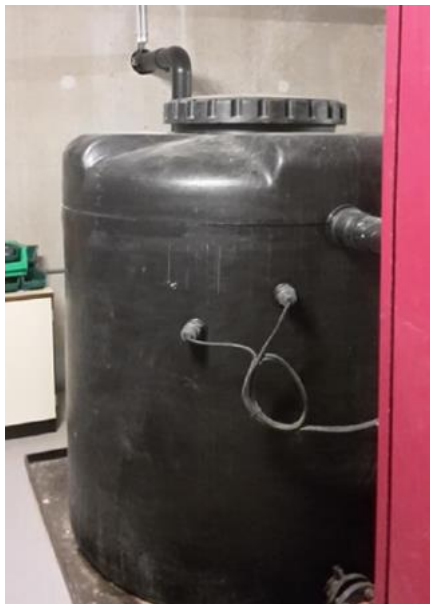
Figure 79 Cuve des urgences d'une capacité de 1,1 m 3 (source : CHU NDB, 2023)
