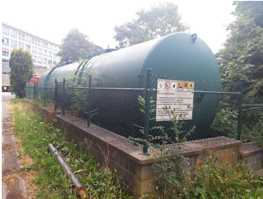
Figure 55 Citerne de 60.000 L de mazout (Source : CSD, juil. 2023)
