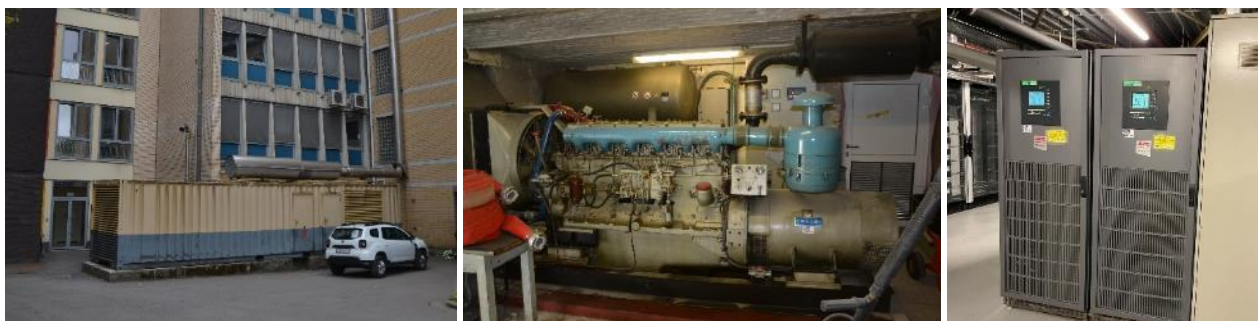
Figure 32 Groupes électrogènes de l'aile C (gauche) et du château (centre), ainsi que les UPS (droite) (source : CSD, juill. 2023)
