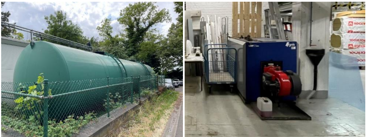
Figure 28 Cuve à mazout de la chaufferie centrale de l'hôpital (gauche) et chaudière à mazout Ygnis, dédiée à la préparation ECS des bâtiments principaux de l'hôpital (droite), utilisées avant février 2021 (source : CSD, juill. 2023)
