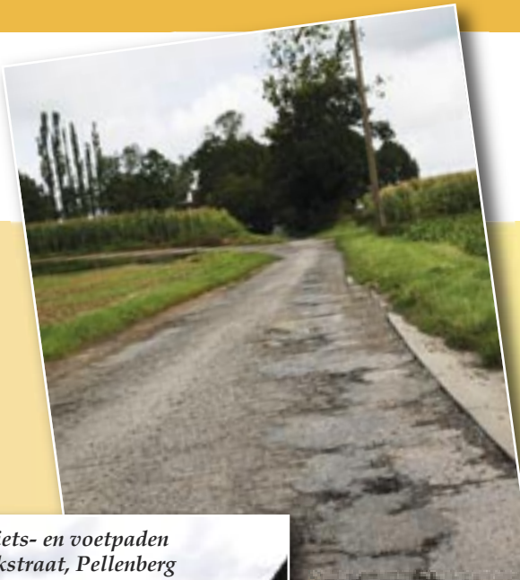
Verouderde rioleringen Dorpsstraat, Lubbeek
