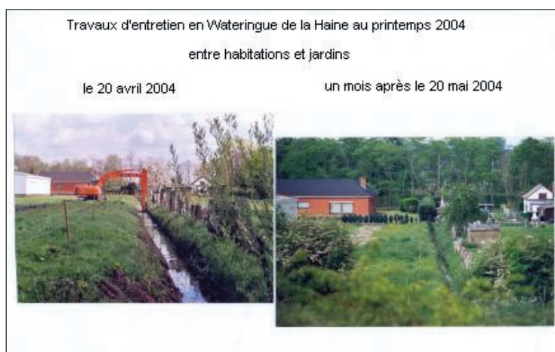
Figure 12 - Les entretiens doivent également s'opérer près des habitations, malgré la difficulté d'accès et l'espace restreint. [Source : AWW, s.d.]
