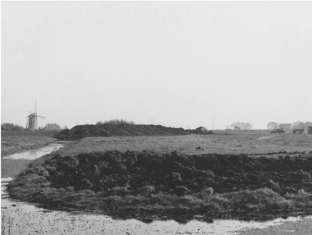
Het verzetten van grond: op de voorgrond is bovengrond weg gegraven, op de achtergrond wordt de nieuwe boezemkade opgeworpen. Links de Zwanburger molen.
