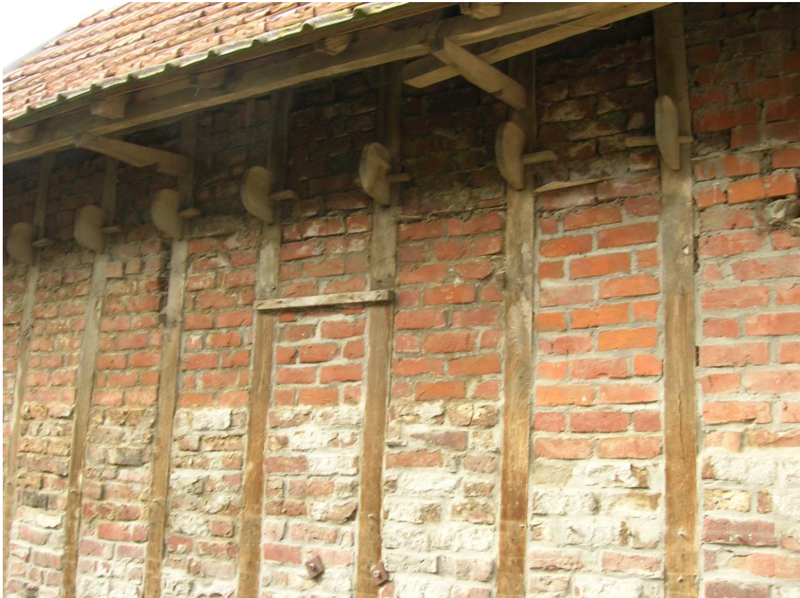
Hier is duidelijk te zien dat de oorspronkelijke ast 'versteend' is en zien we tevens de ankerbalkverbindingen die de vloek dragen.
