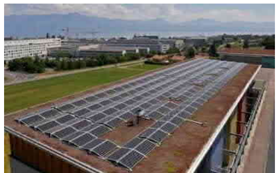
Panneaux photovoltaïques – Coquerellaz
