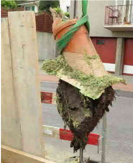
Embranchement obstrué par une racine, forte diminution de l'écoulement sur le collecteur communal d'eaux claires
