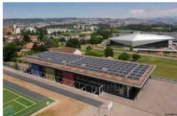
Installation photovoltaïque en toiture – Collège de la Coquerellaz
