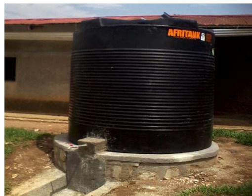
Citerne d'eau potable au Lycée technique (photo APROJUMAP)
