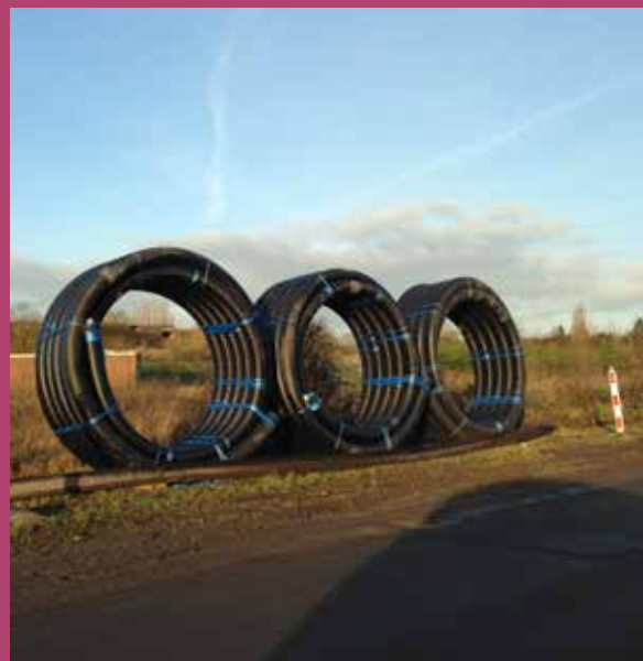
Travaux de pose des conduites calorifugées pour la connexion géothermique d'AW Europe
