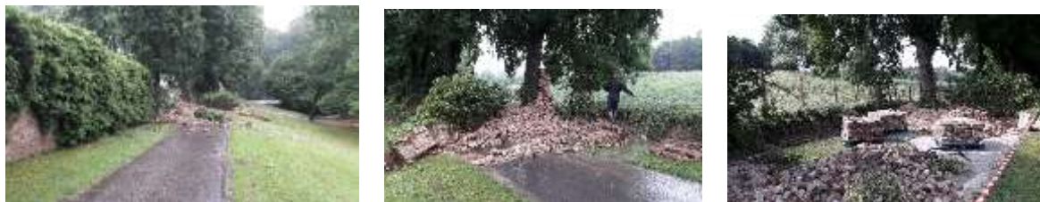
Effondrement du mur le long de la rue des Carmes
