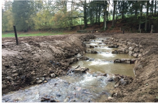
Commune de Stavelot, cours d'eau le Sot Laloux, n° 6-57. Construction d'une passe à poissons
