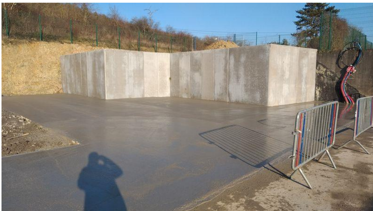
Aménagement pour la mise en place de conteneurs au hall technique à Vervies
