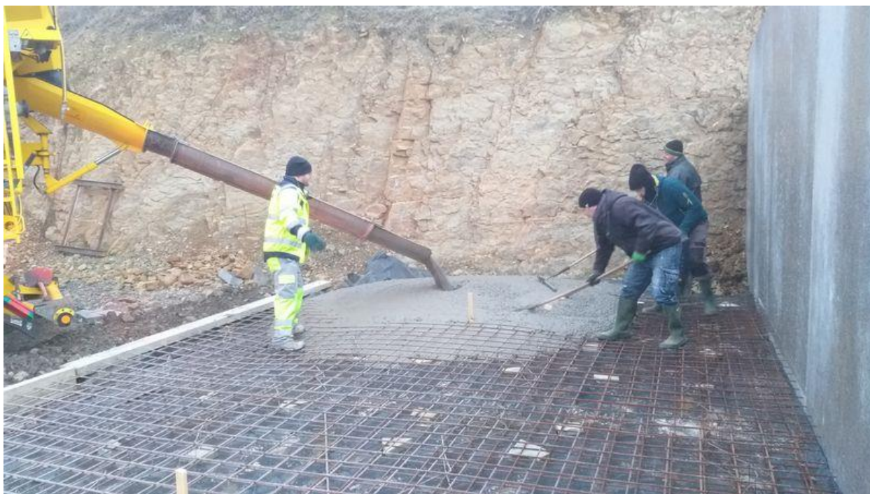
Aménagement pour la mise en place de conteneurs au hall technique à Vervies
