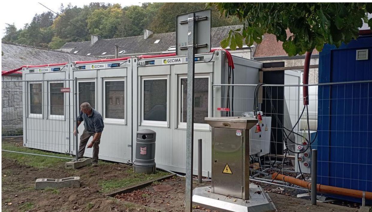
Branchement à l'égouttage des containers « école » place Châtillon à Nismes
