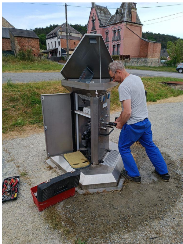
Réparation de la borne mobilhome à Treignes
